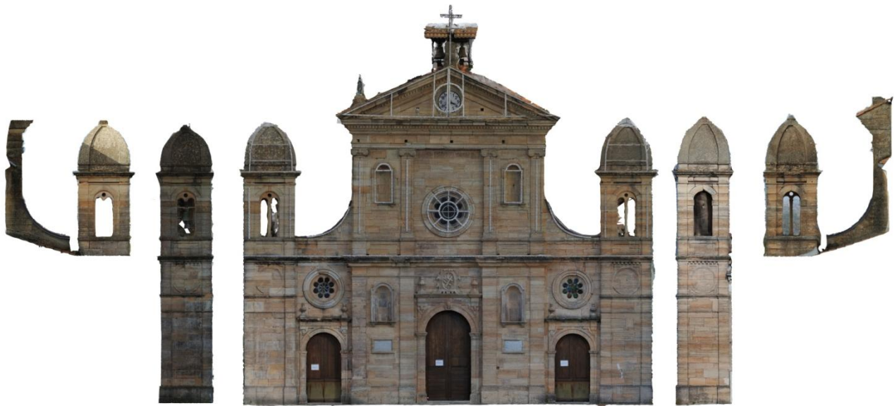
Figura 35: Superfici degradate della facciata del Santuario di Santa Liberata.
