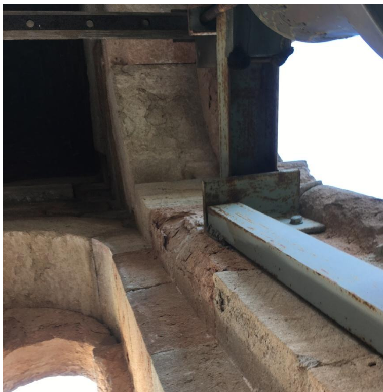
Figura 27: Degrado del materiale in prossimità della struttura campanaria.
