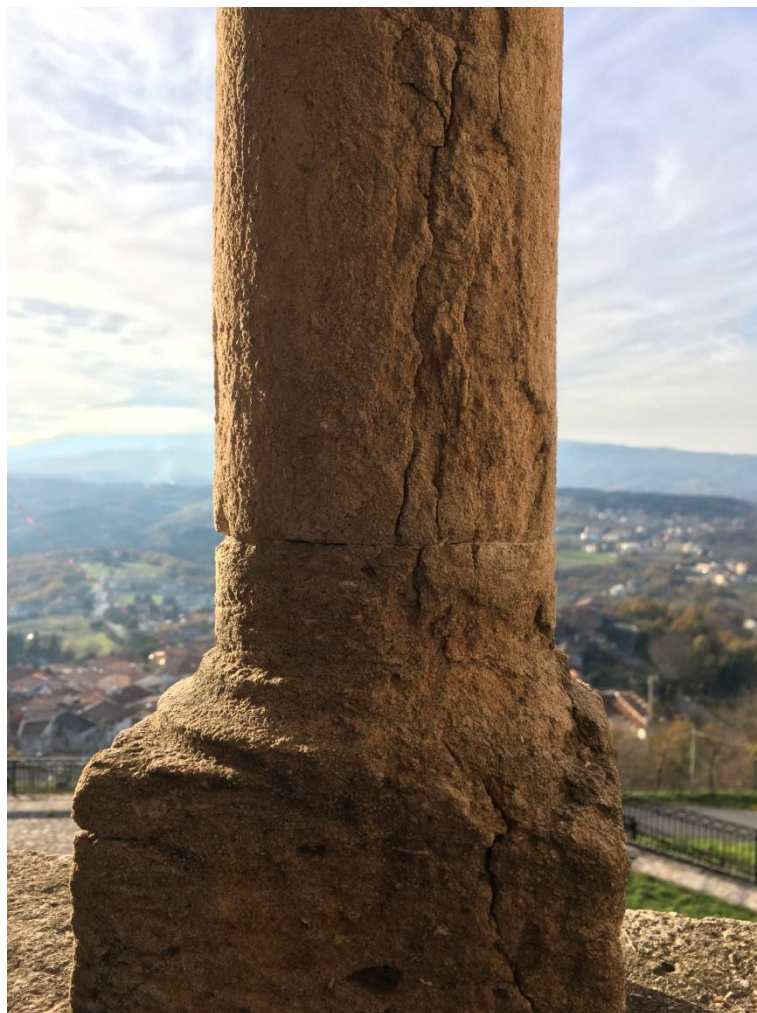
Figura 28: Degrado del materiale.
